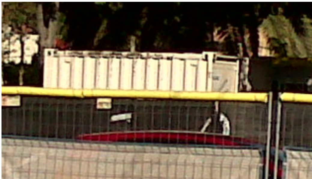
Caseta de obras donde se ubica el equipo con punto de muestreo en Plaza Can Rosès
